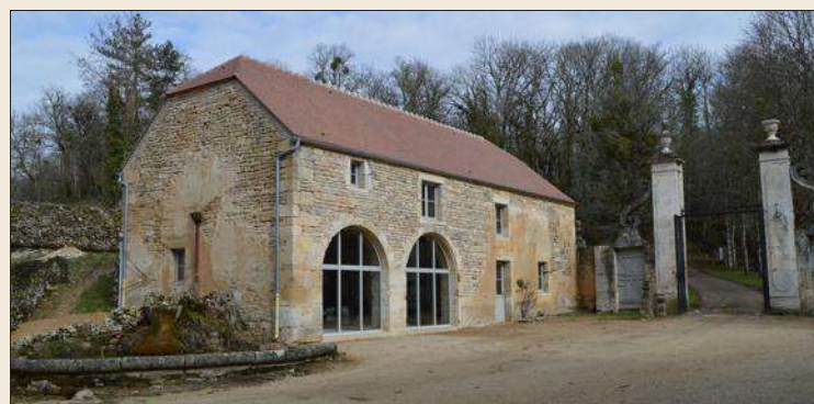
Le chantier, qui s'est terminé en février, a permis de mettre à l'abri de l'air et de l'eau l'ancienne remise-écurie de l'abbaye d'Oigny.
